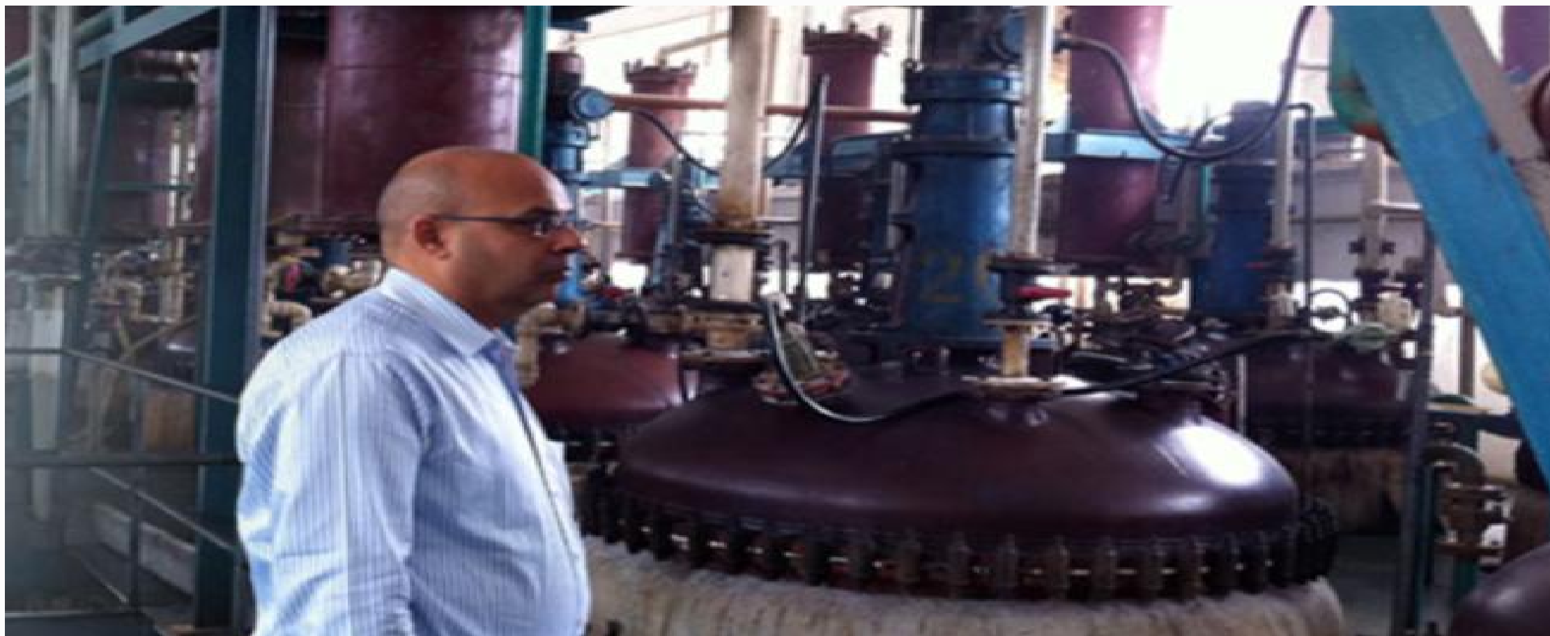
搪玻璃釜现场
